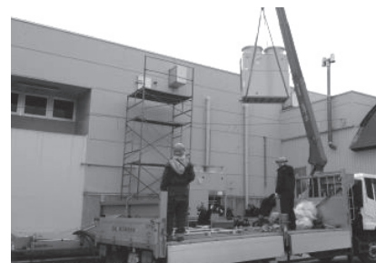
冷凍機設置状況
