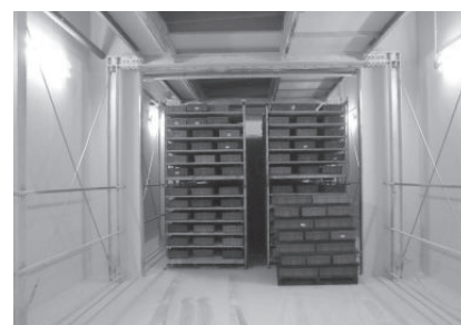
急速凍結庫内(-43℃)
