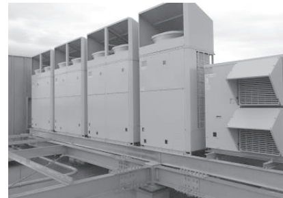
冷凍機(屋上設置)
