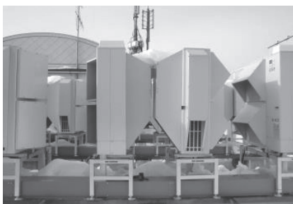
エアコン室外機(屋上設置)
