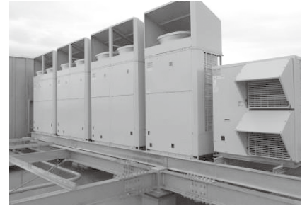
冷凍機(屋上設置)
