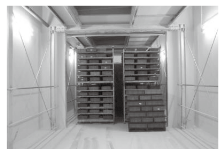
急速凍結庫内(-43℃)
