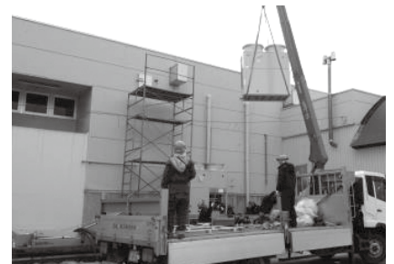
冷凍機設置状況
